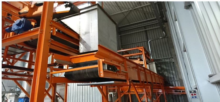
Rysunek 5 Odbiór frakcji metali żelaznych z separatorów 4-2 oraz 4-5
