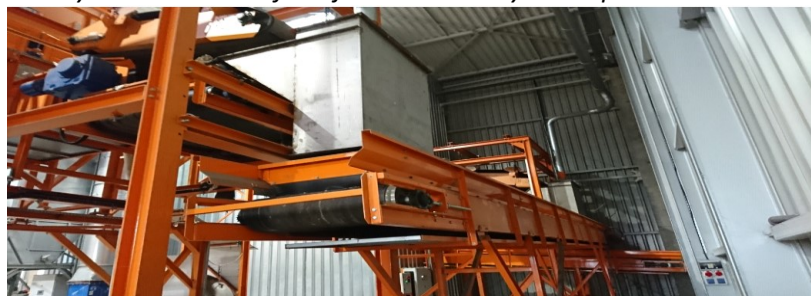
Rysunek 5 Odbiór frakcji metali żelaznych z separatorów 4-2 oraz 4-5
