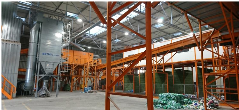
Rysunek 7 Widok na kabinę sortowniczą i przenośnik transportowy 3-5.
